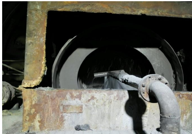
شکل ۴: نمای کلی از دوش شستشو در سرند ترومل
